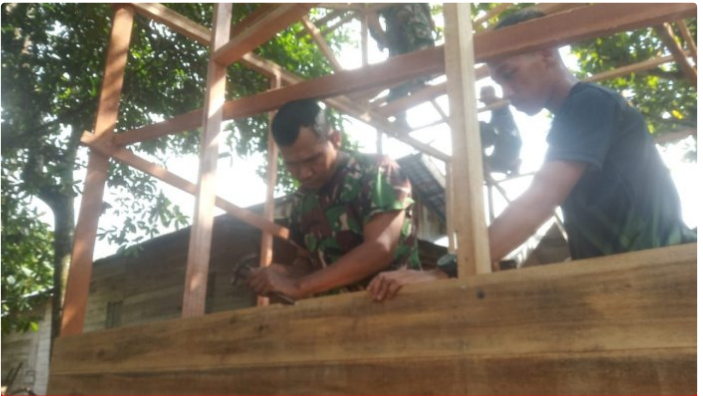
Rehab Tidak Layak Huni TMMMD Ke-116 Kodim HST Pasang Dinding Dan Lantai Rumah
